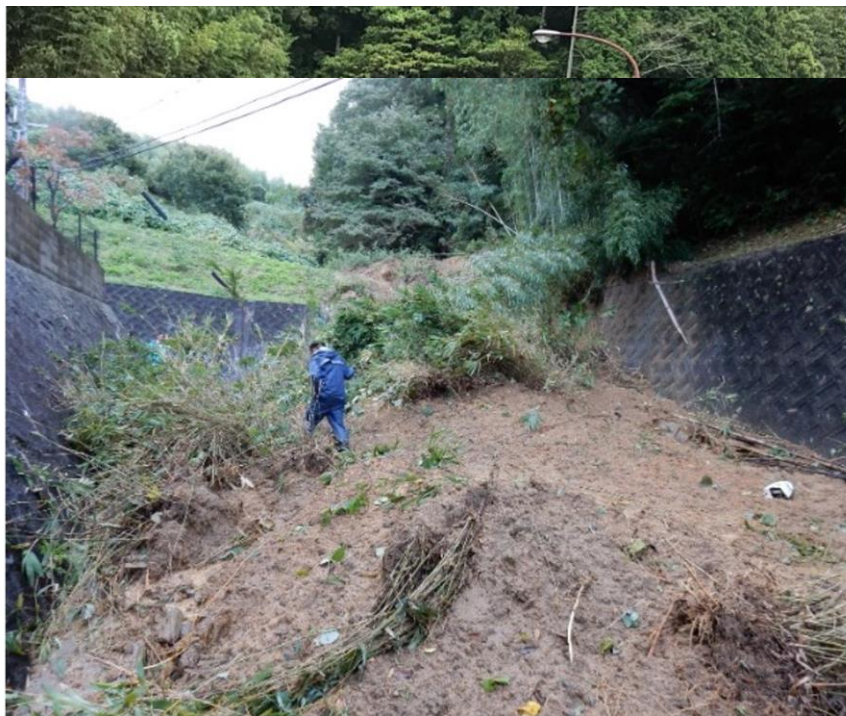
平成29年10月 富田林市 山腹崩壊により市道に土砂流出
