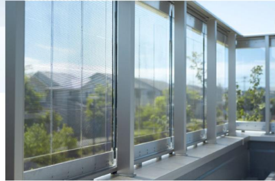
バルコニー内からの ペロブスカイト太陽電池設置の様子
