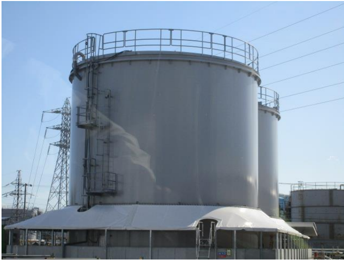
（処理水タンク（溶接型））
